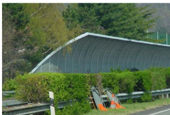
Abb. 20.30 Gekrümmte Randwand (Innenseite absorbierend), Nationalstrasse A2, Bellinzona TI
