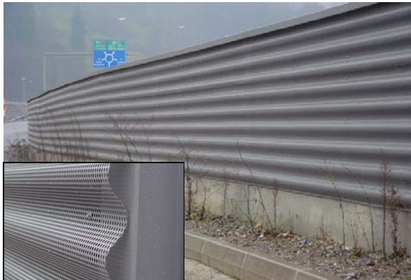
Abb. 20.41 Lärmschutzwand mit gelochtem SINUS-Blech, A2 Zubringer Zentrum, Horw LU
